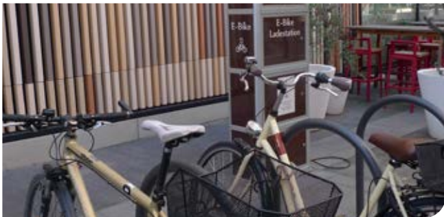
Abbildung 38: Ladeinfrastruktur an einem City-Einkaufszentrum
